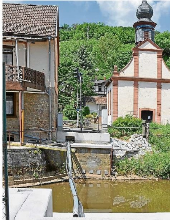
Wie lange wird es wohl noch dauern, bis die für Ende Oktober 2015 anvisierte Fertigstellung der kleinen Brücke in Altenbamberg endlich Wirklichkeit wird? Nur die Rohre für die Leitungen der Versorgungssträger spannen sich über die Alsenz.
